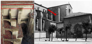
Foto Izquierda: Vista exterior (desde el oeste) del crucero meridional. En la parte alta del muro, se aprecia claramente el recocado de los realizado en mampostería para soportar las cubiertas de madera y así aligerar el peso sobre las bóvedas.
